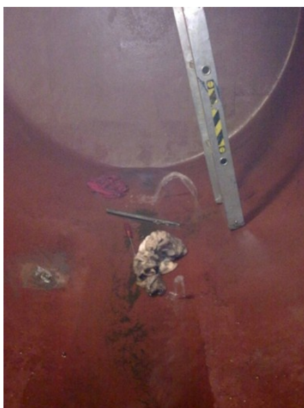
korrodierter Tank (Wassereintritt)
